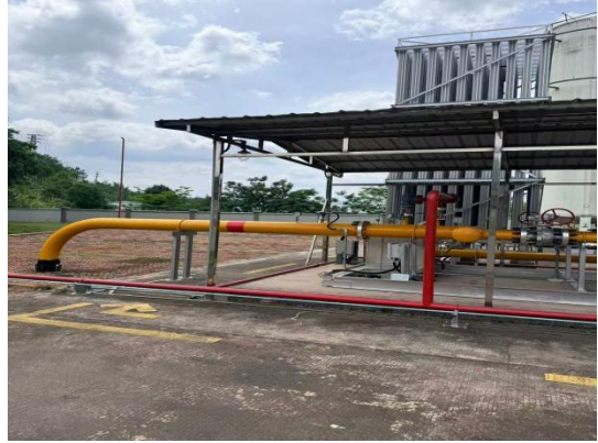
供气管道出口阀门
