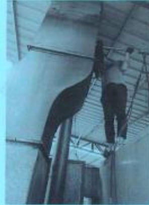
烤漆废气处理后采样口
