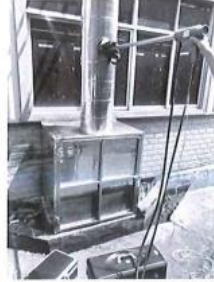
有组织废气排放口
