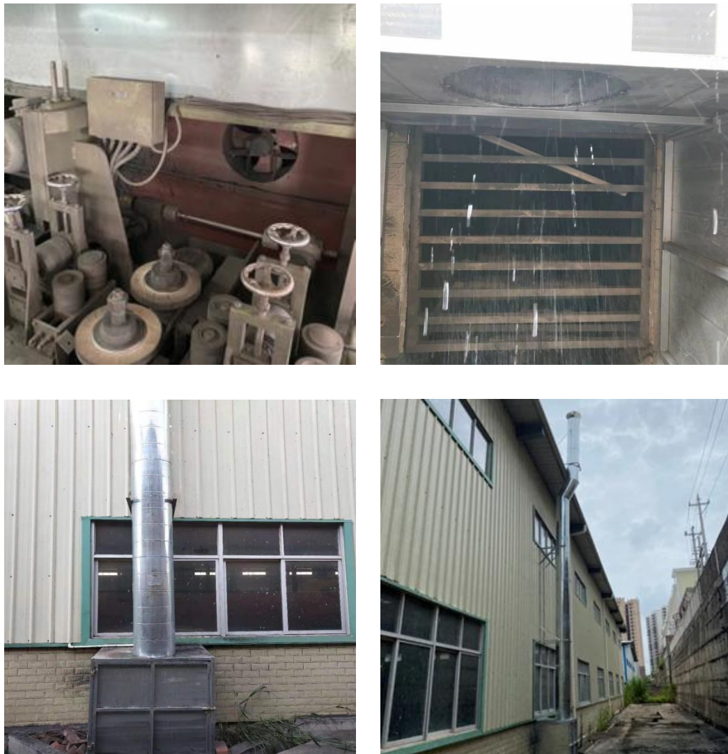
图 4.1-1 废气处理设施图
