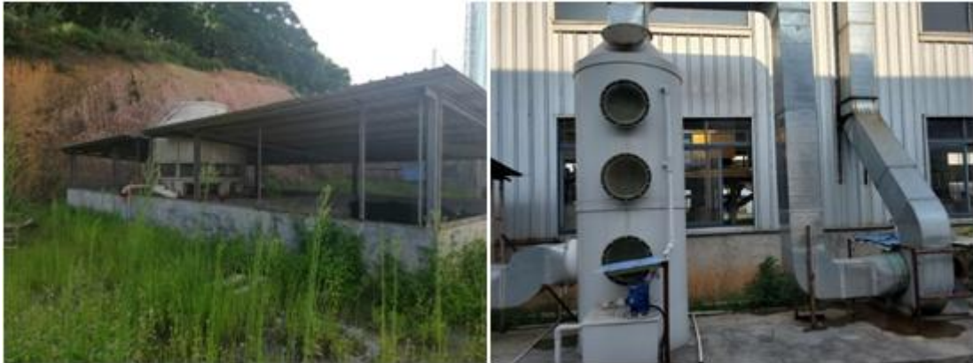
图 4.1-3 冷却塔循环水池及喷淋塔
