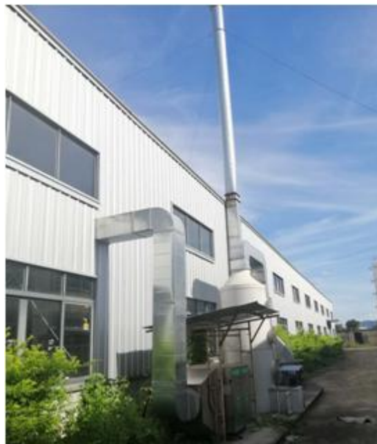
图 4.1-1 有机废气处理设施及排气筒
